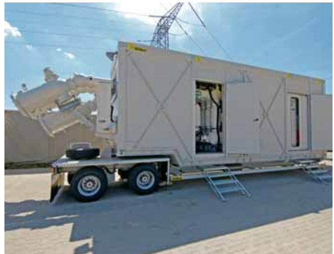
Fig. 3.1-41: Containerized 8DN9 switchgear bay
